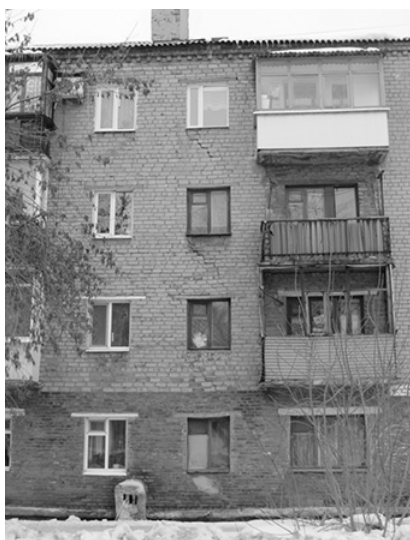
Рис. 5. Повреждение участка стены главного фасада жилого дома по ул. Первомайской, 31 в г. Горловка в зоне влияния сосредоточенных деформаций
