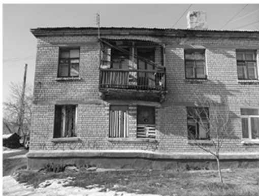
Рис. 6. Повреждение участка стены главного фасада жилого дома по ул. Стожка, 69 в г. Горловка в зоне влияния сосредоточенных деформаций
