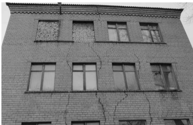
Рис. 5. Трещины в стене правого фасада
