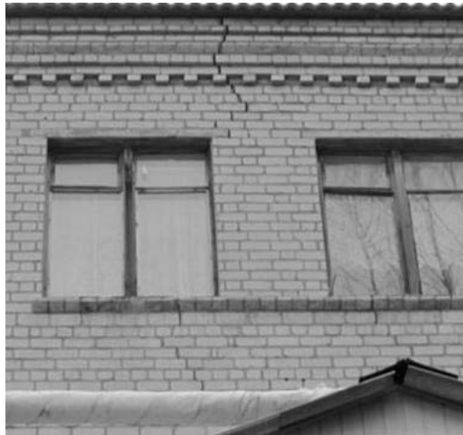
Рис. 2. Рисунок 2 – Трещины в стене главного фасада
