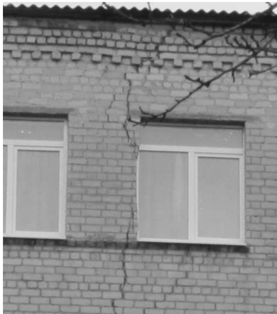
Рис. 3. Вертикальная трещина в средней части дворового фасада
