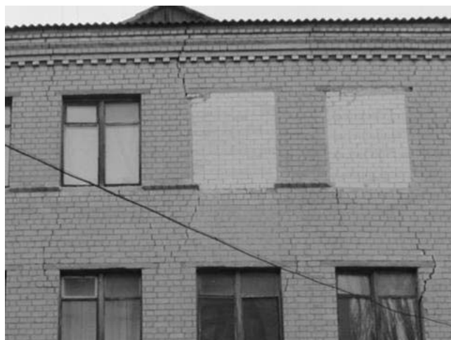
Рис. 4. Трещины в стене левого фасада
