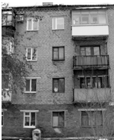
Рис. 6. Трещины в стене главного фасада жилого дома по ул. Первомайской, 31в
