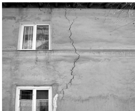
Рис. 4. Трещина в стене левого фасада жилого дома по ул. Свердлова, 26
