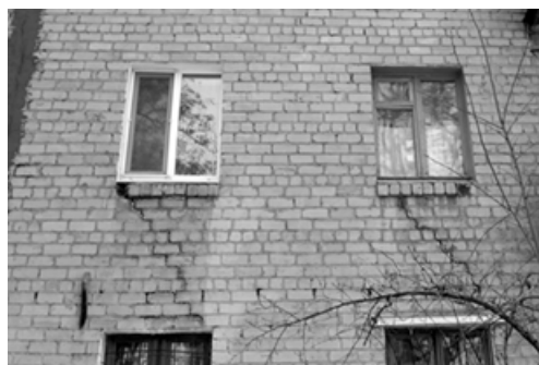
Рис. 5. Трещины в стене главного фасада жилого дома по ул. Горького, 33б
