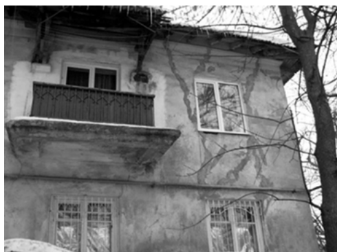
Рис. 3. Трещины в стене левого фасада жилого дома по ул. Свердлова, 21
