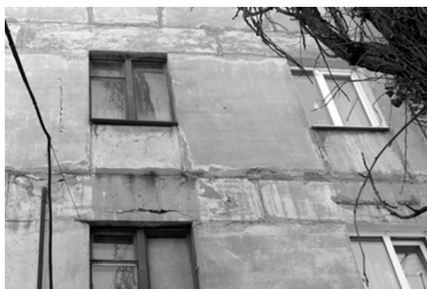
Рис. 7. Повреждения стены дворового фасада жилого дома по ул. Свердлова, 32
