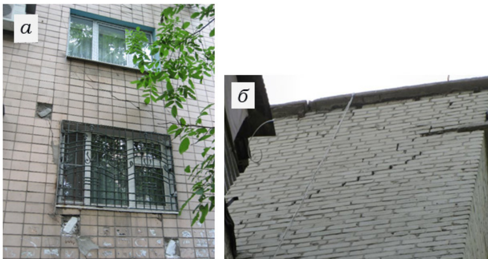
Рис. 6. Трещины в стенах жилого дома № 40 по пр. Театральному: а – стена главного фасада; б – стена правого фасада
