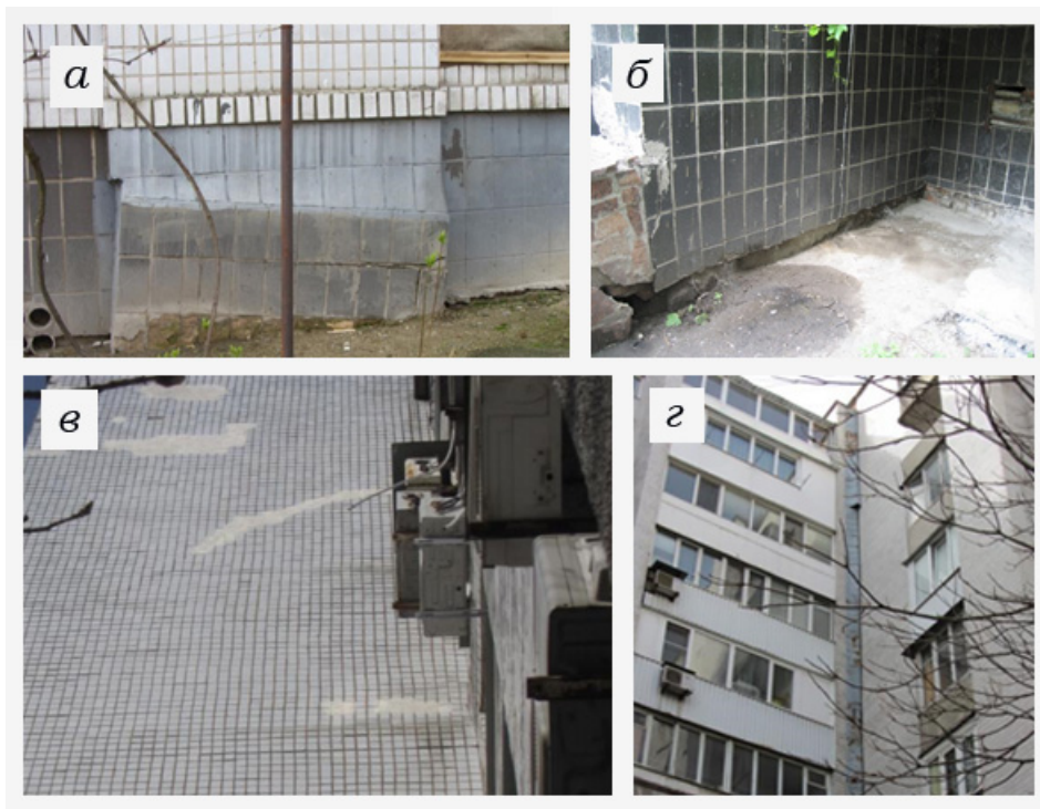
Рис. 5. Повреждения жилых домов по пр. Театральному: а, в – жилой дом № 23; б, г – жилой дом № 23а
